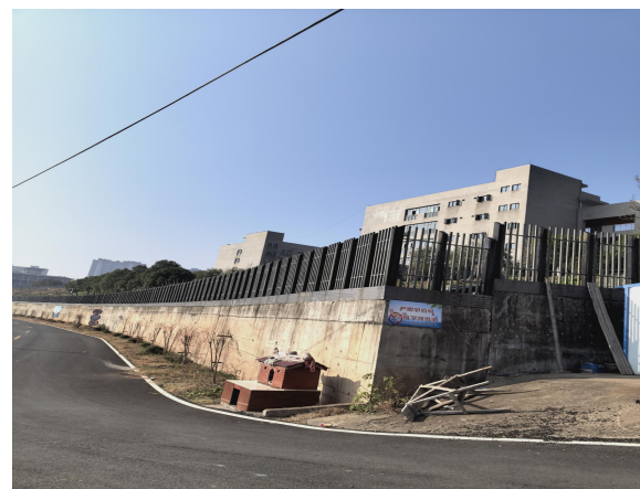
城南污水处理厂出水 2#泵站西南思源学校
