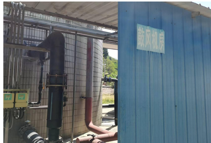
渗滤液污水处理站鼓风机房
