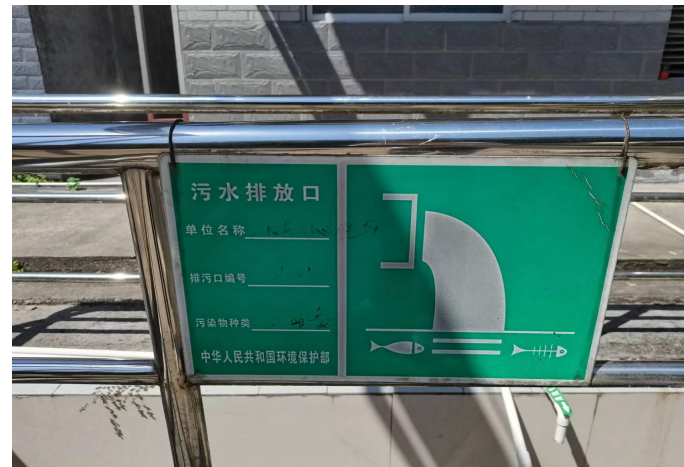
渗滤液污水处理站排放口
