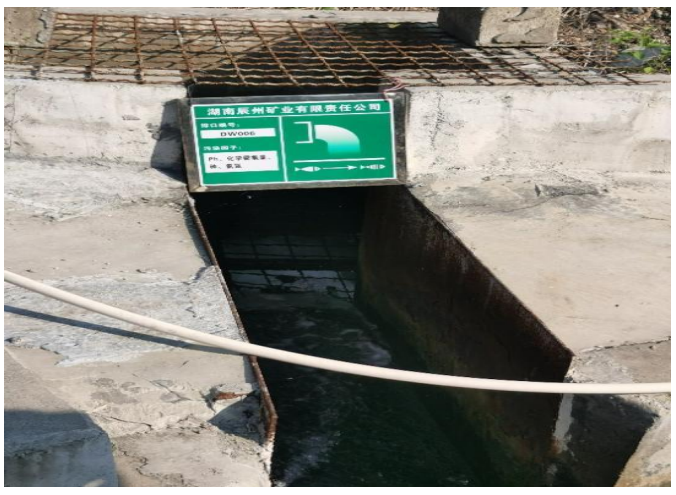
三期废水处理站排口 DW006
