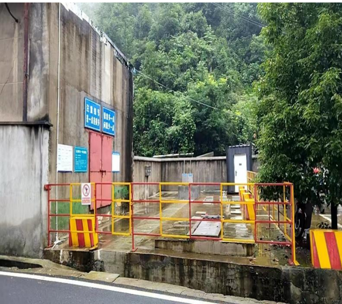
冶炼厂生活污水处理站
